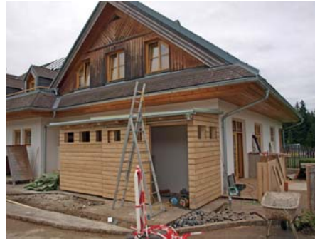
Zubau einer Gerätehütte im Kindergarten Hohenau, sowie Errichtung einer behindertengerechten Zugangsrampe und Zaunsanierung
